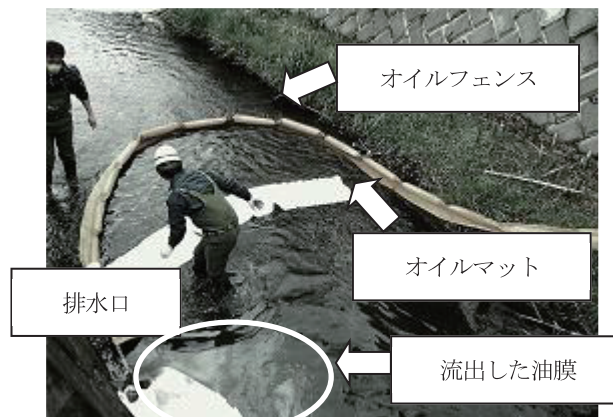
河川に油が流出(オイルマット、オイルフェンス設置)
